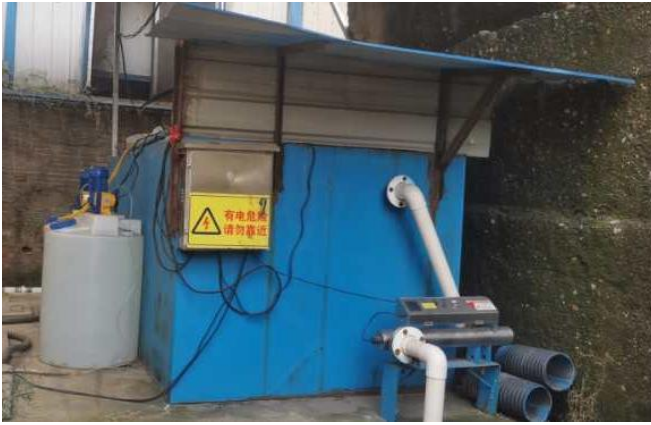
污水处理装置
